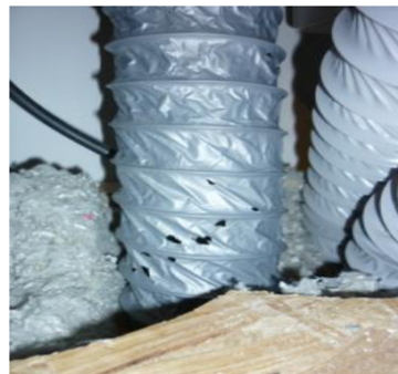
Figure 3. Conduits percés Maison n°14
