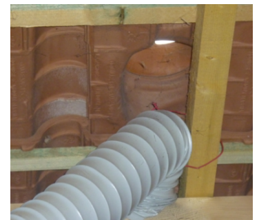
Figure 4. Réseau d'extraction non raccordé et sortie d'air obstruée Maison n°18
