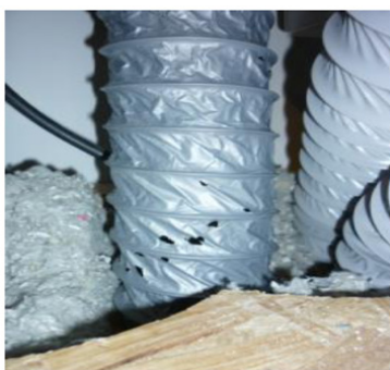
Figure 3. Conduits percés Maison n°14
