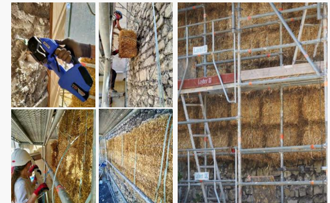
Focus sur la mise en œuvre des bottes de pailles sur le chantier
